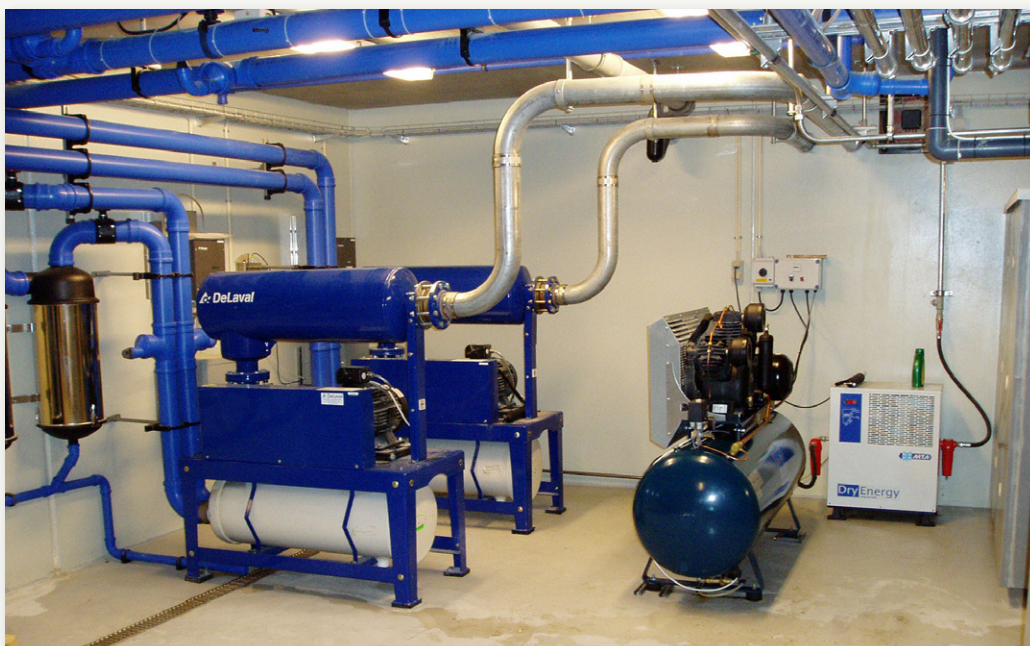
Teknikrum under malkecenter med vakuumpumper og trykluftkompressor til malkeanlægget.
