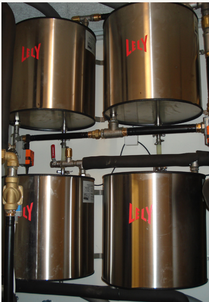
Rørkølere på AMS anlæg kølet med isvand.
